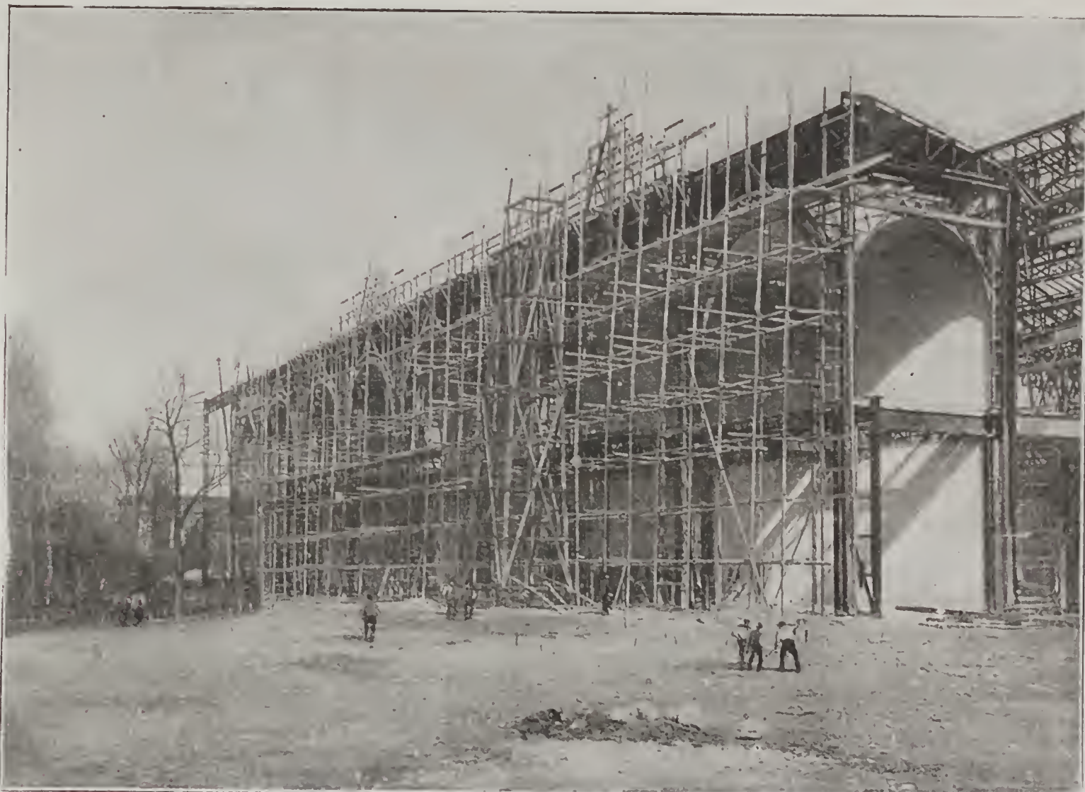
AU CHAMP-DE-MARS. — Façade en construction du Palais des Mines et de la Métallurgie.
